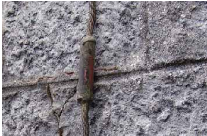
La giuntura della treccia di rame troncata dal fulmine
